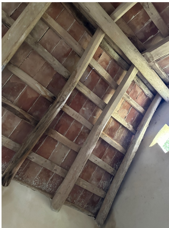
Vista interior de magatzem (coberta amb filtracions)
