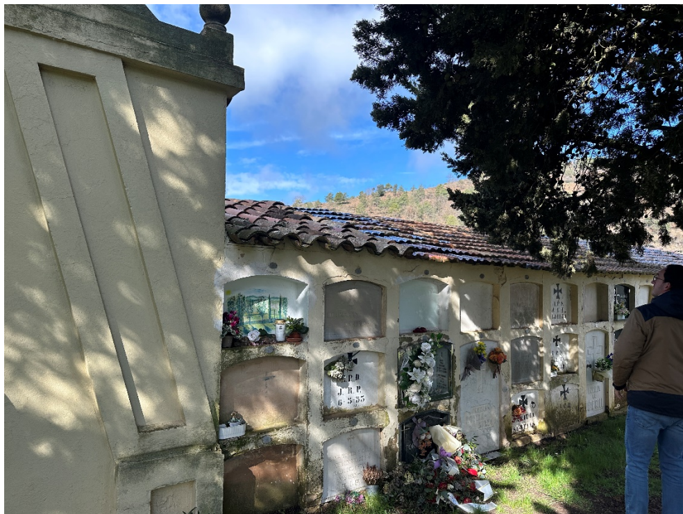
Bloc de nínxols amb tram de teules a renovar
